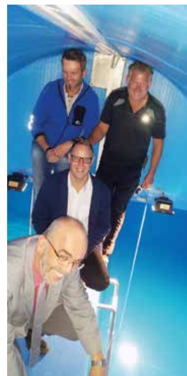
Vzbgm. Walter Pacher, Wirtschaftshofleiter Helmut Wallner, GR Marc Weitensfelder und Ing. Harald Alberer im Wasserhochbehälter Kalvarienberg
